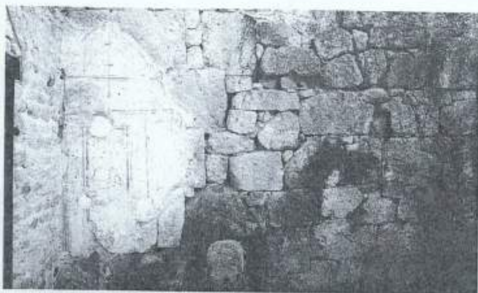
Figura 17 Da sinistra: l'intonaco romano al di sopra dell'opera a scacchiera che restauro l'opera poligonale. Foto SAEM
